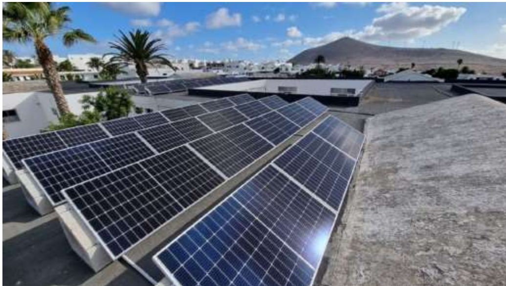
Figura 3.53. Instalación fotovoltaica en la Reserva de Biosfera de Lanzarote.
