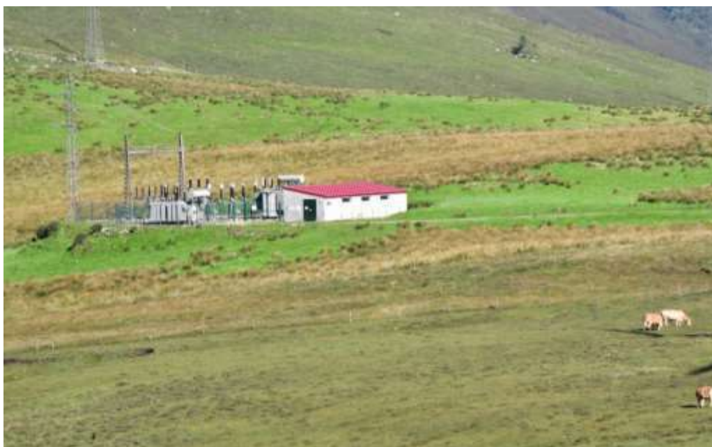
Figura 10.63. Estación eléctrica emplazada sobre la antigua turbera de Chan da Cruz. El área que rodea la estación aparece transformada en un pastizal y un juncal de escasa reducida.
