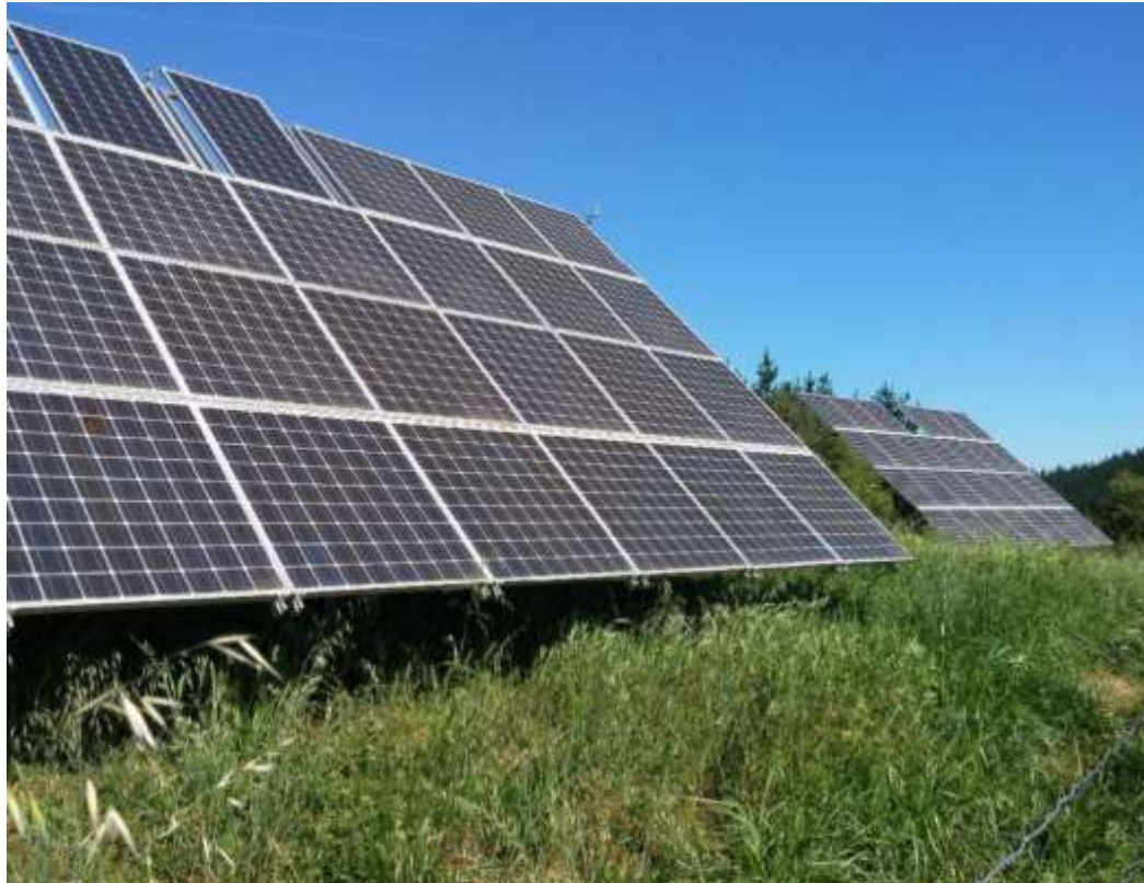
Figura 8.10. Instalación fotovoltaica de conexión a autoconsumo (10kw) en Vilaboa (Bóveda), Reserva de Biosfera Ribeira Sacra. Fotografía; Mecánica Solar, O Saviñao.
