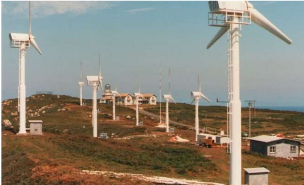
Figura 3.28. Vista general del Parque Eólico de Estaca de Bares (Mañón, A Coruña), designado habitualmente como Parque Eólico de Galicia. Fotografía de Lara Coira publicada en Dínamo (2017).
